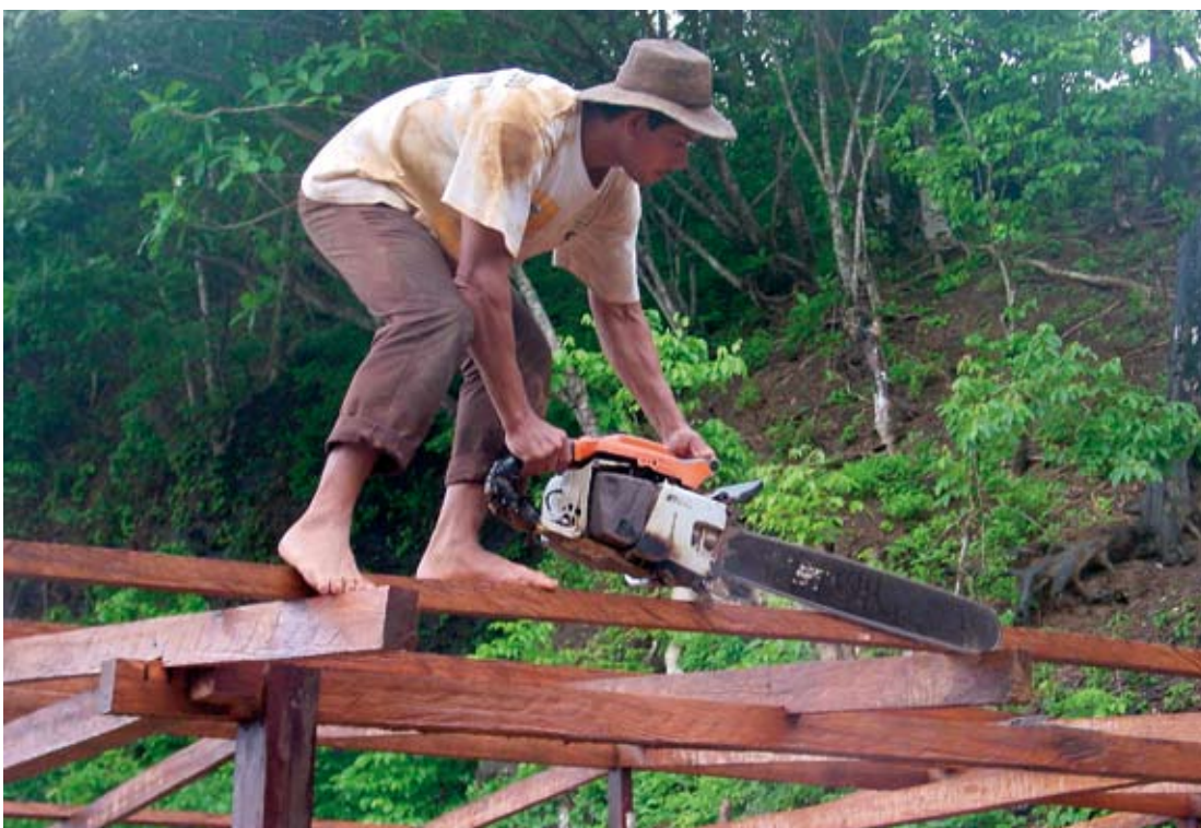
Der nahe Wald liefert benötigtes Baumaterial. Geschicktes Hantieren mit der Kettensäge ersetzt viele andere Werkzeuge.
